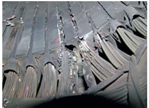
Figura 1. Núcleo con daño severo.
